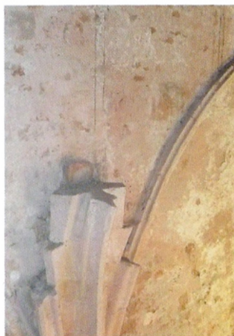
↓ 176. Manque d'un élément structural (altération profonde) (Cliché : Elsa Ricaud, 2008)
