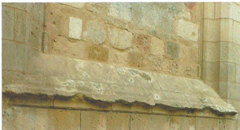
↑ 175. Pierre épaufrée (principalement au niveau des éléments saillants) (Cliché : Elsa Ricaud, 2008)
